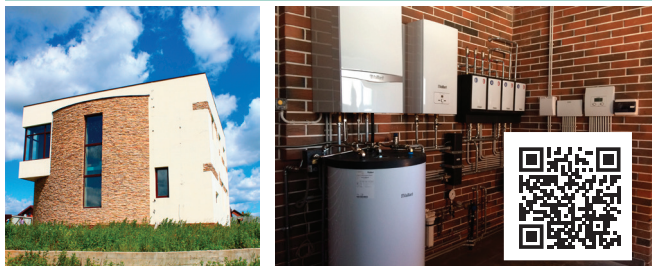
Реализованные объекты на основе оборудования Vaillant
